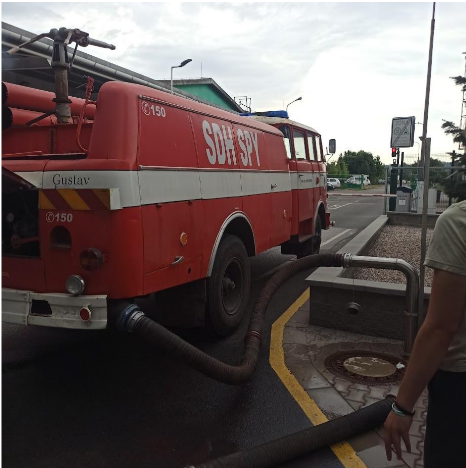
Servisbal – revize požárního systému
